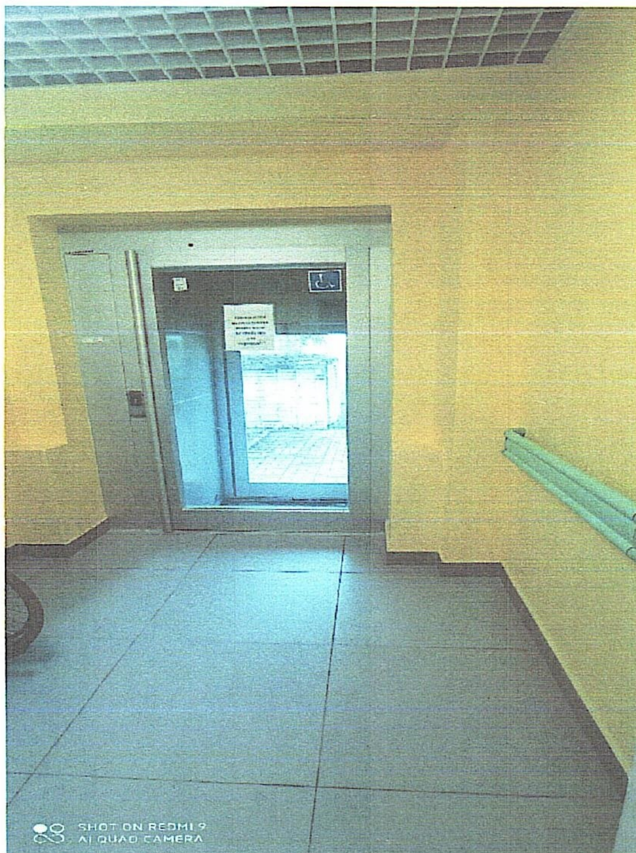
Фото № 9 Подъёмная платформа (наружная)
