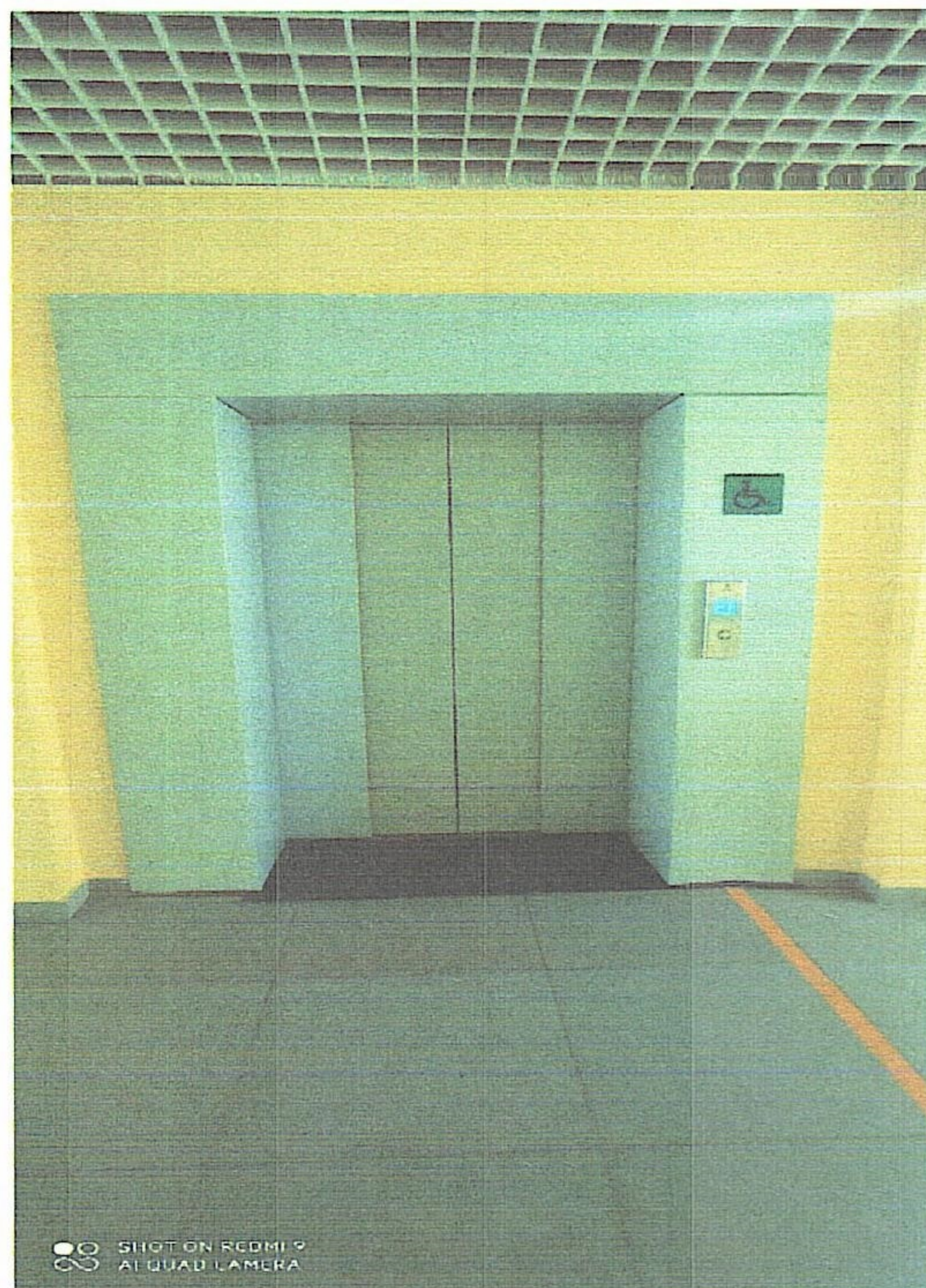
Фото № 10 Лифт пассажирский
